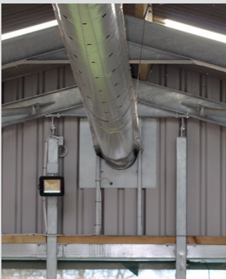
Belüftungsschlauch mit Abhängung und Spannseilen
