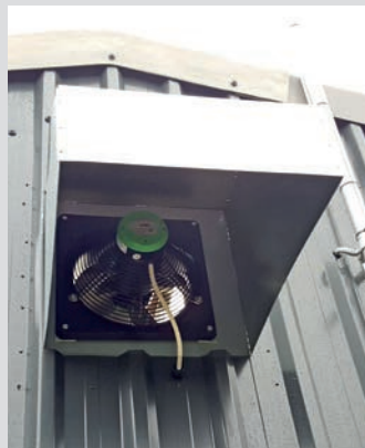
Ventilator mit Ansaugkasten und Abdeckblech
