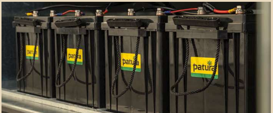
4 große Akkus mit je 200 Ah sorgen für lange Laufzeiten auch bei schlechtem Wetter.
