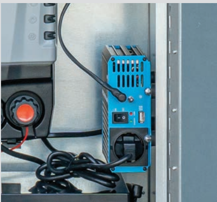
Für den Betrieb des P 8000 ist ein zusätzlicher Wechselrichter verbaut
