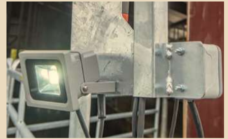
Steckdosen und LED Beleuchtung
