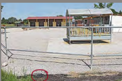
Auslauf eines Offenstalls, befestigt mit Progrid. Hier wurde das Gitter mit Kies überdeckt.
