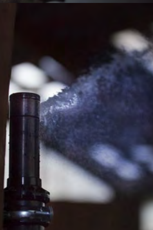
Beregnung in der Reithalle
